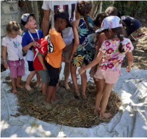
Publié le : dimanche 8 décembre 2024 CHANTIER OUVERT DE LA TYROLIENNE - JUILLET-DÉCEMBRE 2024 Cabinet en bois et torchis - Toilette sèche 1 RUE JULIETTE DODU À MONTREUIL-SOUS-BOIS (93100)
